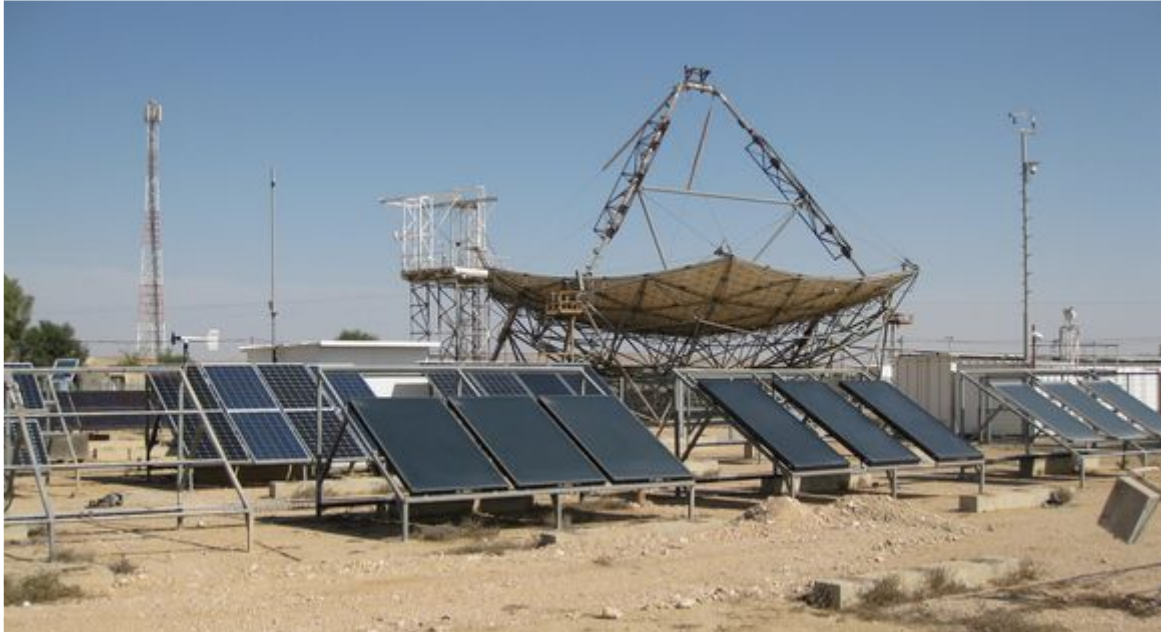
Wissenschaftler des Fraunhofer ISE untersuchen die Alterung von Solarkollektoren, hier in der israelischen Wüste Negev. © Fraunhofer ISE
